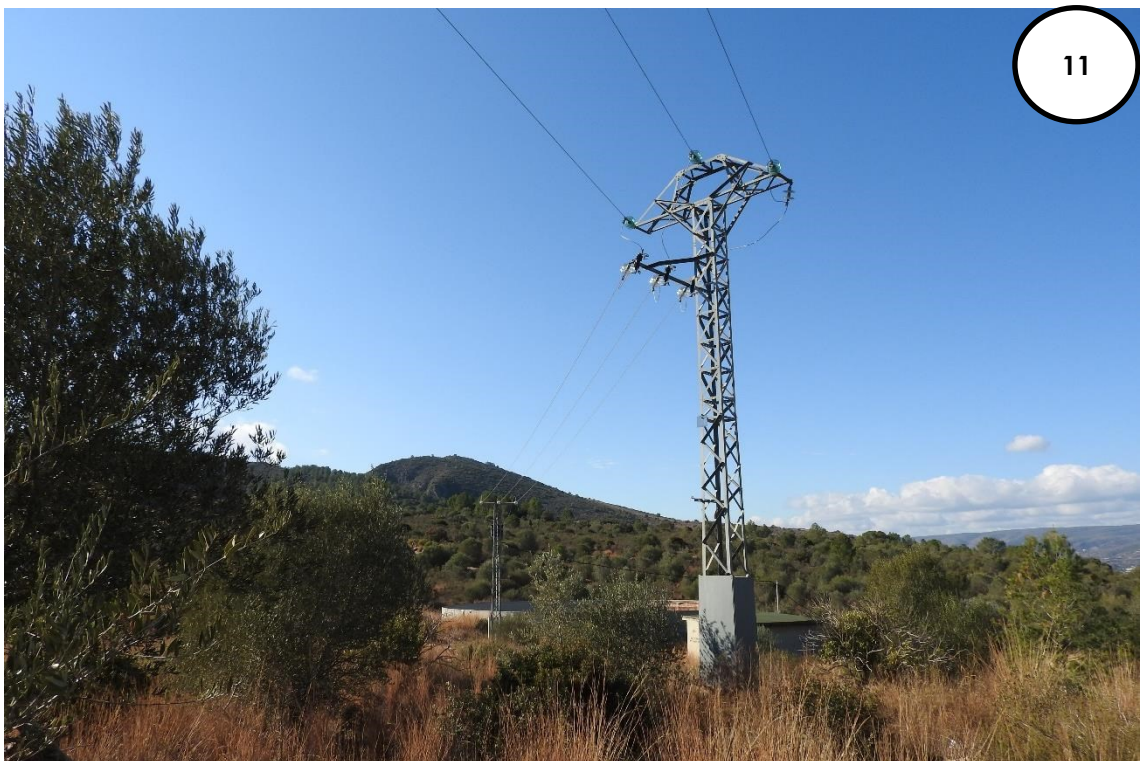
Ilustración 12: Tendido eléctrico existente al que irá conectada la línea eléctrica proyectada.
