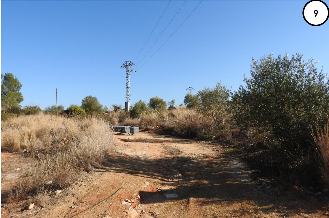
Ilustración 11: Tendido eléctrico existente al que irá conectada la línea eléctrica proyectada.
